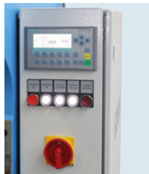
Steuerschrank control cabinet
